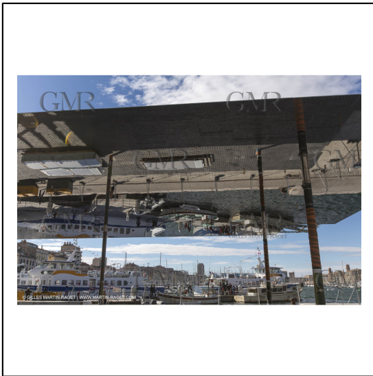
04/02/2013 - Marseille (FRA,13) - Renovation du Quai de la Fraternité (Vieux Port), pose de l'ombrière***04/02/2013 - Marseille (FRA,13) - Vieux Port (historical port) refit - Works on the shadow maker
