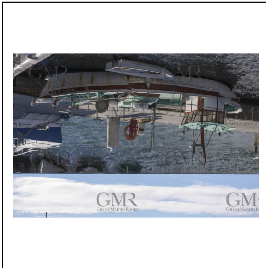
04/02/2013 - Marseille (FRA,13) - Renovation du Quai de la Fraternité (Vieux Port), pose de l'ombrière***04/02/2013 - Marseille (FRA,13) - Vieux Port (historical port) refit - Works on the shadow maker
