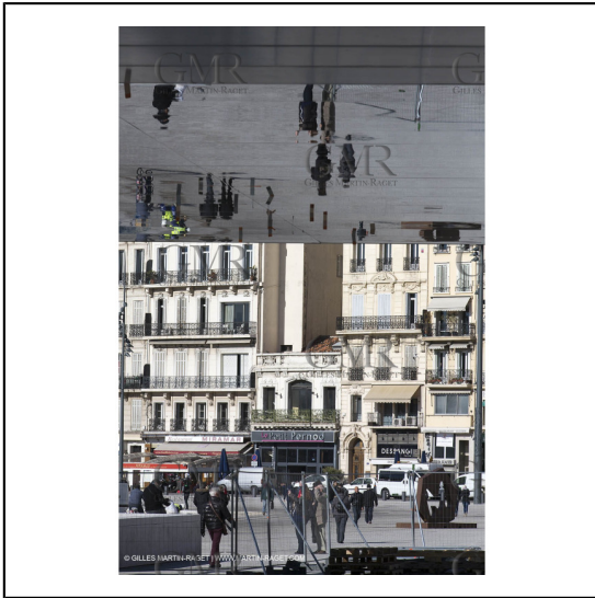
04/02/2013 - Marseille (FRA,13) - Renovation du Quai de la Fraternité (Vieux Port), pose de l'ombrière***04/02/2013 - Marseille (FRA,13) - Vieux Port (historical port) refit - Works on the shadow maker
