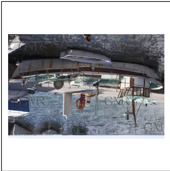
04/02/2013 - Marseille (FRA,13) - Renovation du Quai de la Fraternité (Vieux Port), pose de l'ombrière***04/02/2013 - Marseille (FRA,13) - Vieux Port (historical port) refit - Works on the shadow maker
