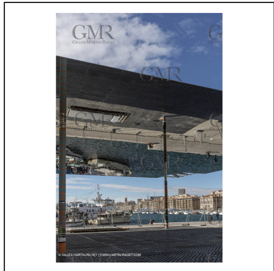
04/02/2013 - Marseille (FRA,13) - Renovation du Quai de la Fraternité (Vieux Port), pose de l'ombrière***04/02/2013 - Marseille (FRA,13) - Vieux Port (historical port) refit - Works on the shadow maker
