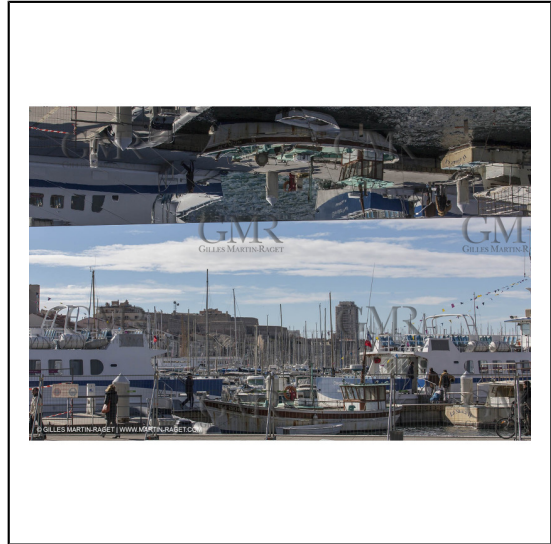
04/02/2013 - Marseille (FRA,13) - Renovation du Quai de la Fraternité (Vieux Port), pose de l'ombrière***04/02/2013 - Marseille (FRA,13) - Vieux Port (historical port) refit - Works on the shadow maker
