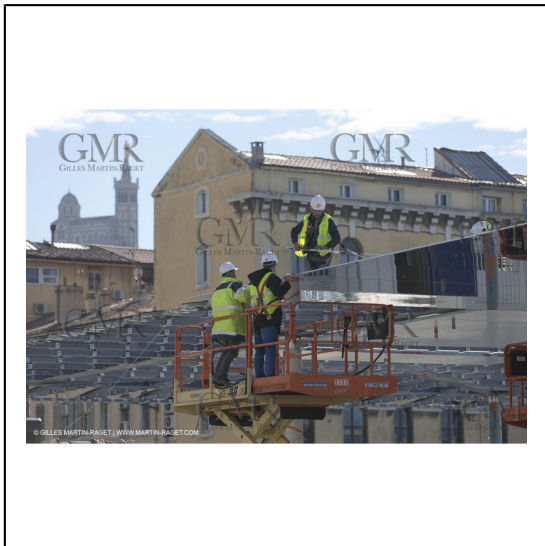
04/02/2013 - Marseille (FRA,13) - Renovation du Quai de la Fraternité (Vieux Port), pose de l'ombrière***04/02/2013 - Marseille (FRA,13) - Vieux Port (historical port) refit - Works on the shadow maker
